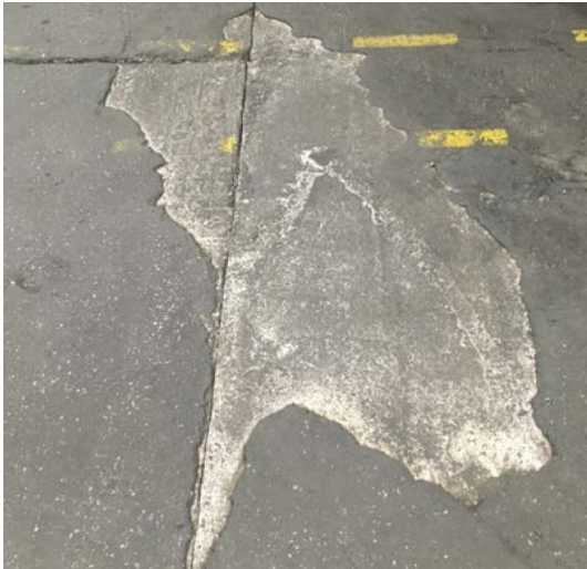
Ausbruchstellen im Lagerbereich
