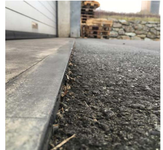
Unebene Toreinfahrten durch Asphaltabsenkung
