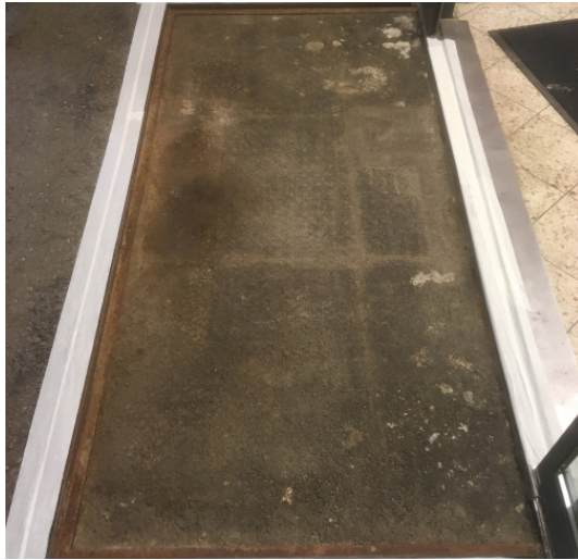
Eingangsbereiche werden oft zu Stolperfallen
