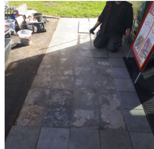
Aufgefrorene Fliesen im Außenbereich
