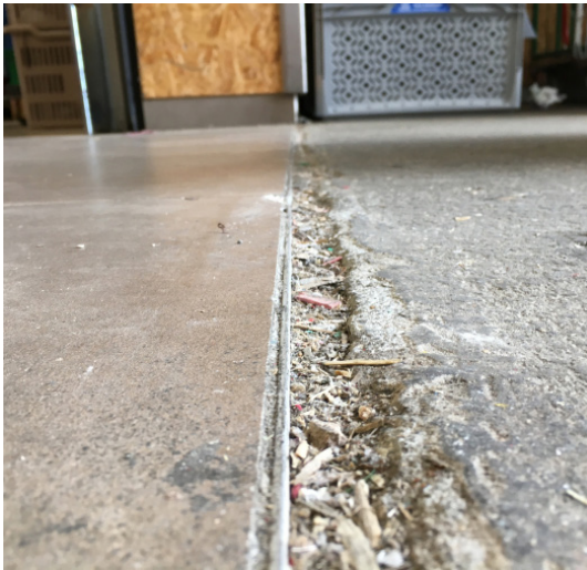
Beschädigter Übergang von Fliesen auf Asphalt
