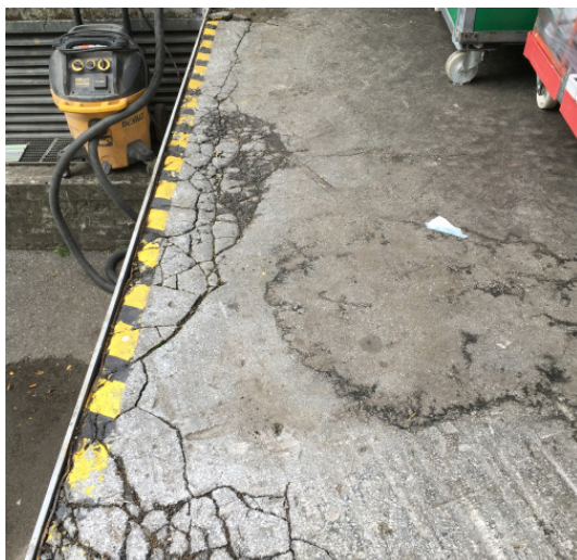
Starke Beschädigungen der Ladezone
