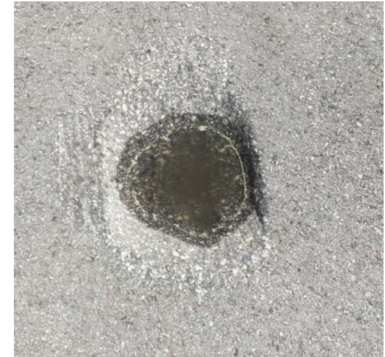
Schlaglöcher im Parkbereich
