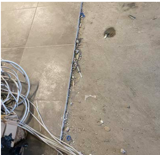
Unebener Übergang von Fliesen auf Asphalt
