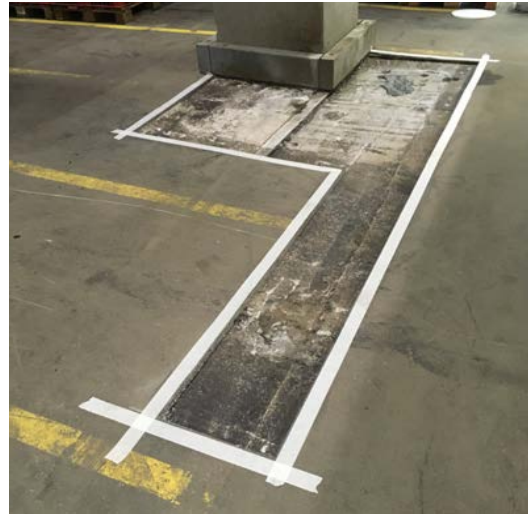
Flächenbeschädigungen im Lagerbereich
