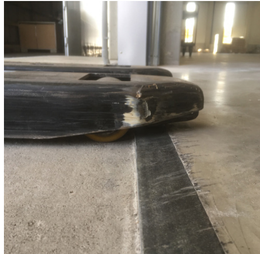
Lagerschäden durch Niveauunterschiede
