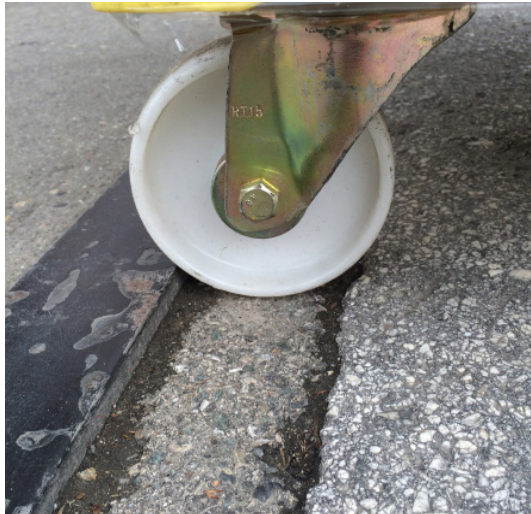
Unfallgefahr durch Stolperstellen
