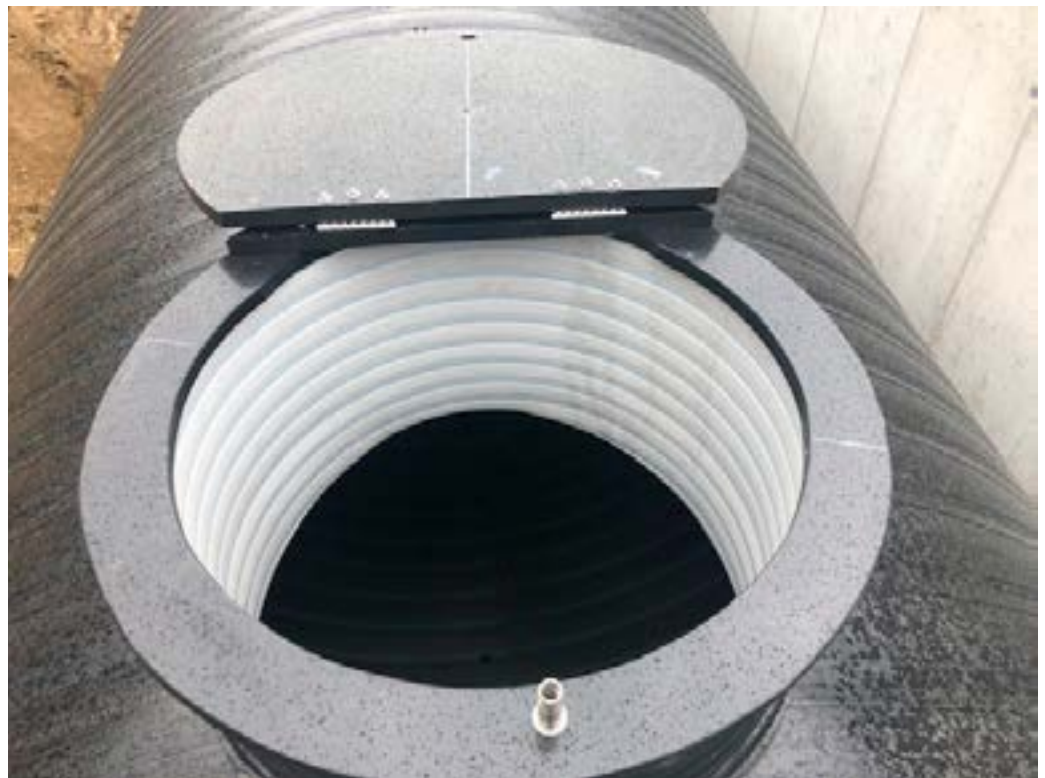
Einstieg in Retentionsbecken aus Kunststoff mit 20.000 Liter Fassungsvermögen.
