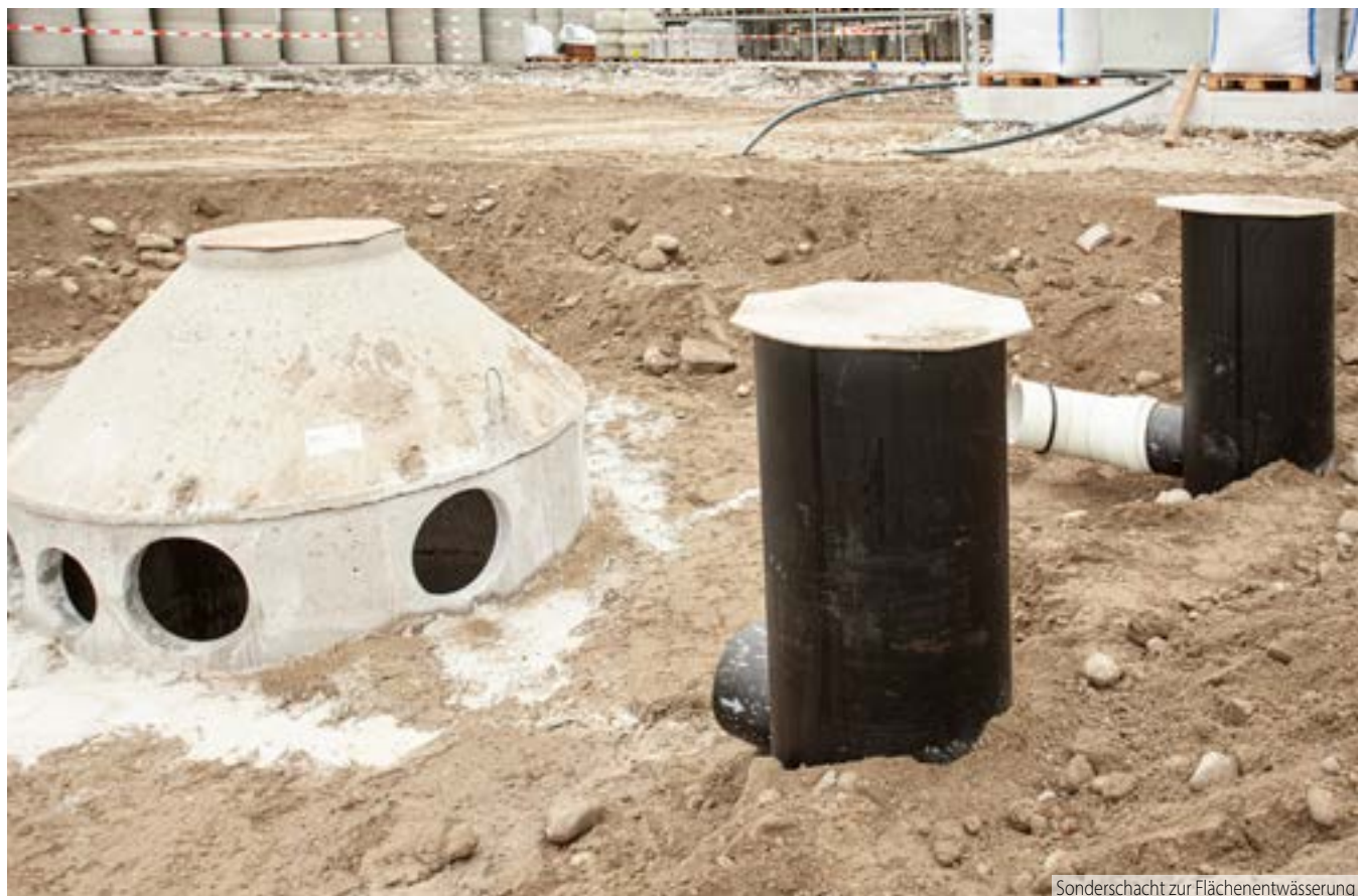
Sonderschacht zur Flächenentwässerung
